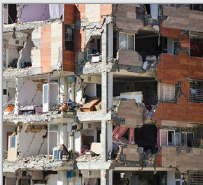
شکل ۴: مسکن مهر سرپل‌دهاب (زلزله سال ۱۳۹۶)
