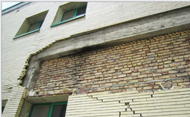
شکل ۱۴: ریزش قطعات آجر نما
