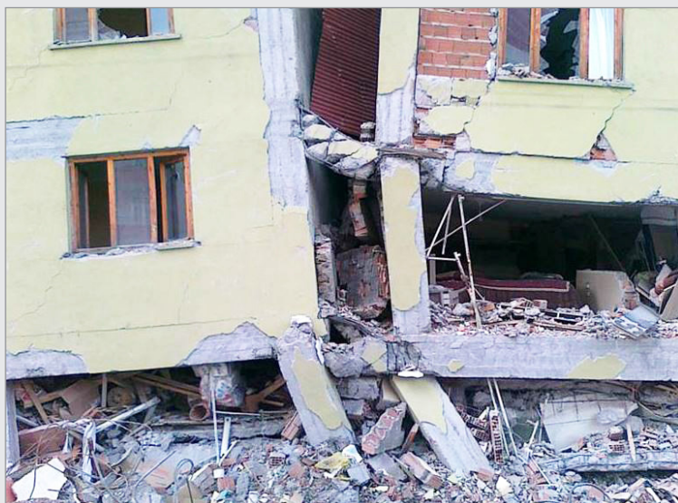
شکل ۸: تخریب ساختمان در اثر طبقه نرم زیرین
