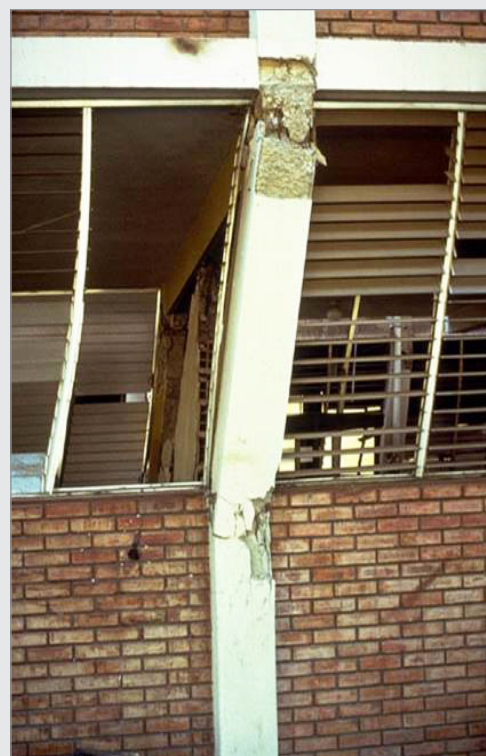
شکل ۹: شکست ترد برشی در ستون بتنی
