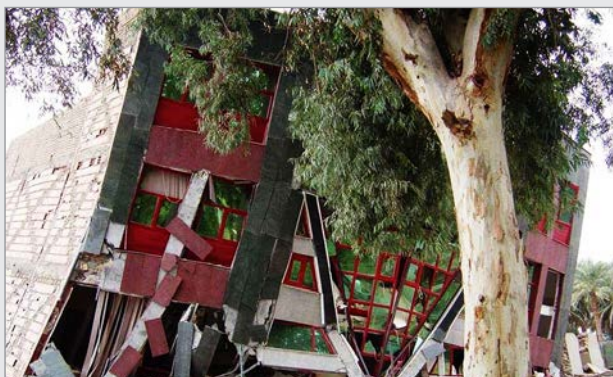
شکل ۱۵: ریزش قطعات سنگ پلاک
