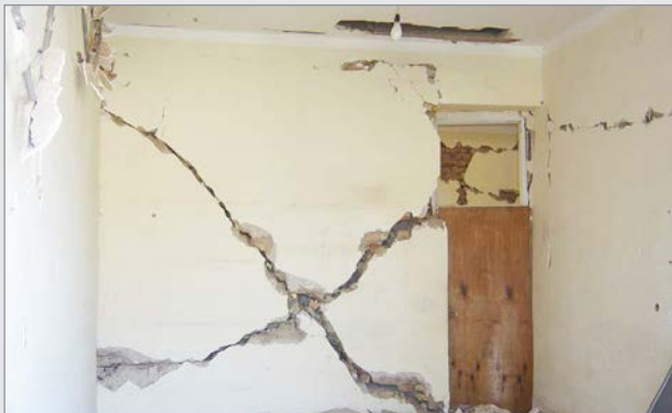
شکل ۱۳: شکست انفجاری دیوار بنایی
